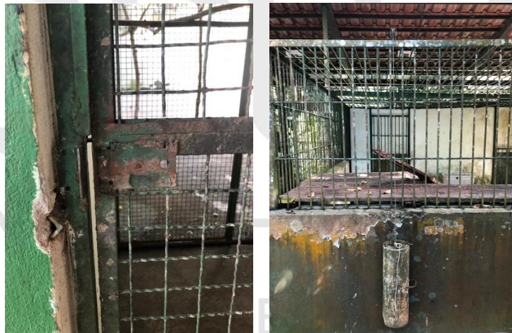
Foto atual da situação das fechaduras e guilhotina do recinto
